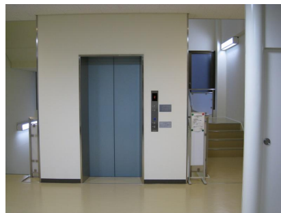
【エレベーター】
